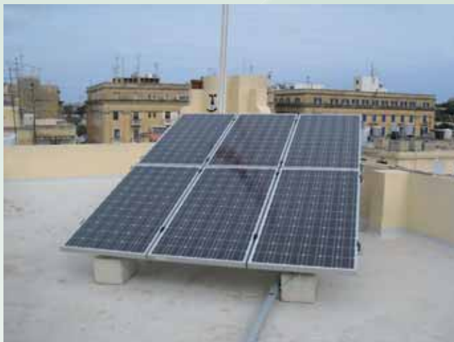
Il-pannelli "photovoltaic" fuq il-bjut tal-Awtorità tad-Djar
