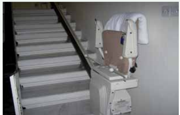
'Stair lift' installat biex jgħin għal access ta' mobilità ahjar
